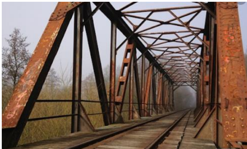
Gambar 1. Jembatan besi berkarat
